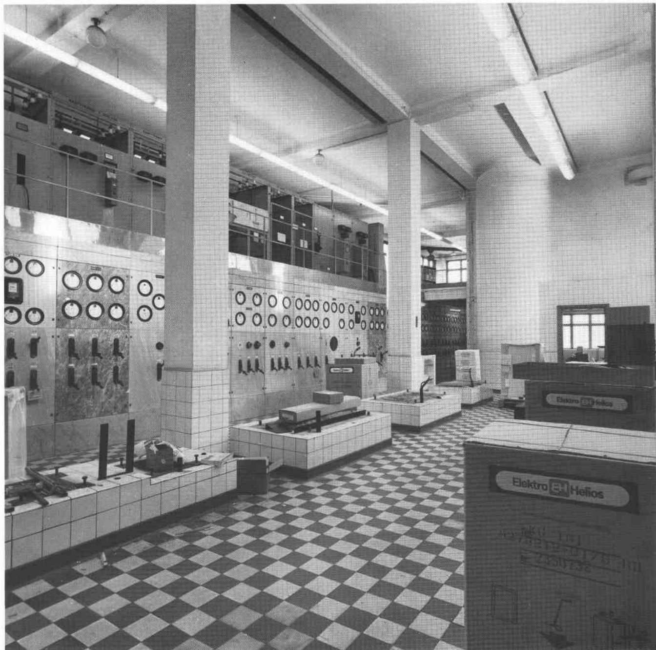
Ställverket i hus 1. Aggregaten avmonterade. S82-0496-3.
