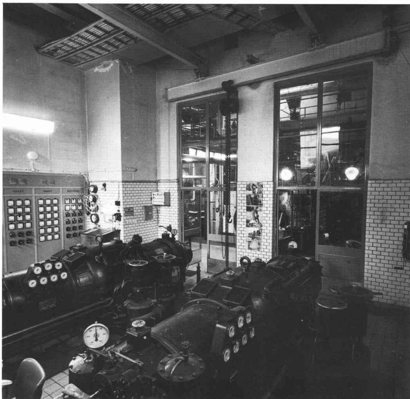
Driftavdelning med ånggeneratorer i panncentralen. S82-0289-10.
