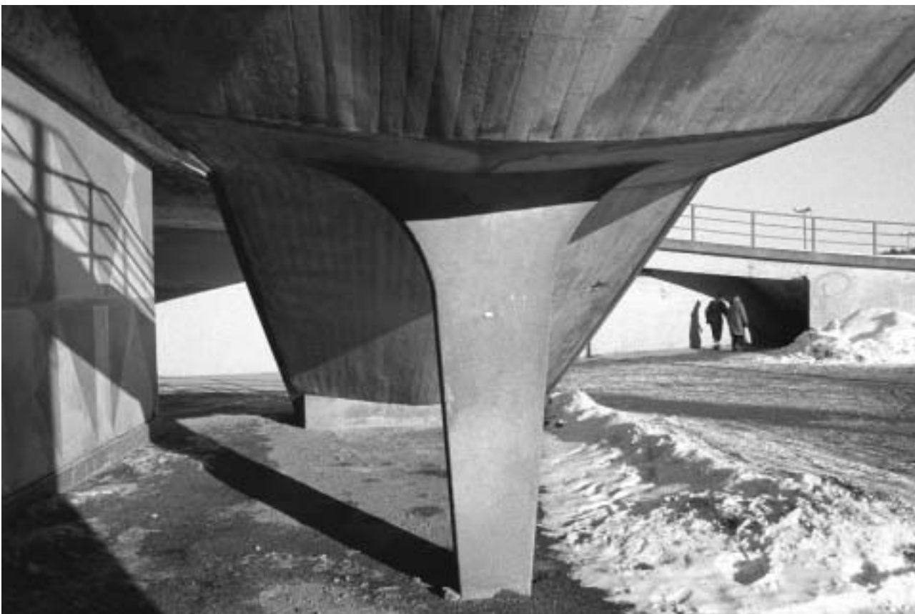
Trappan vid platsen i Södra Slingan vilar på en smäcker formgjuten betongpelare. GF S2005-0020-21A.
