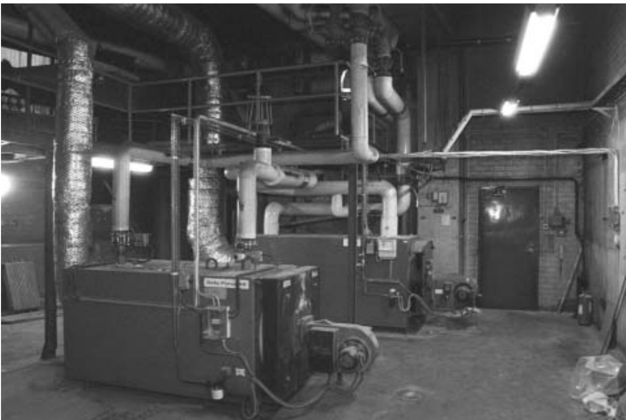
Värmecentralens maskinrum i bottenvåningen. GF S2005-0037-08A.
