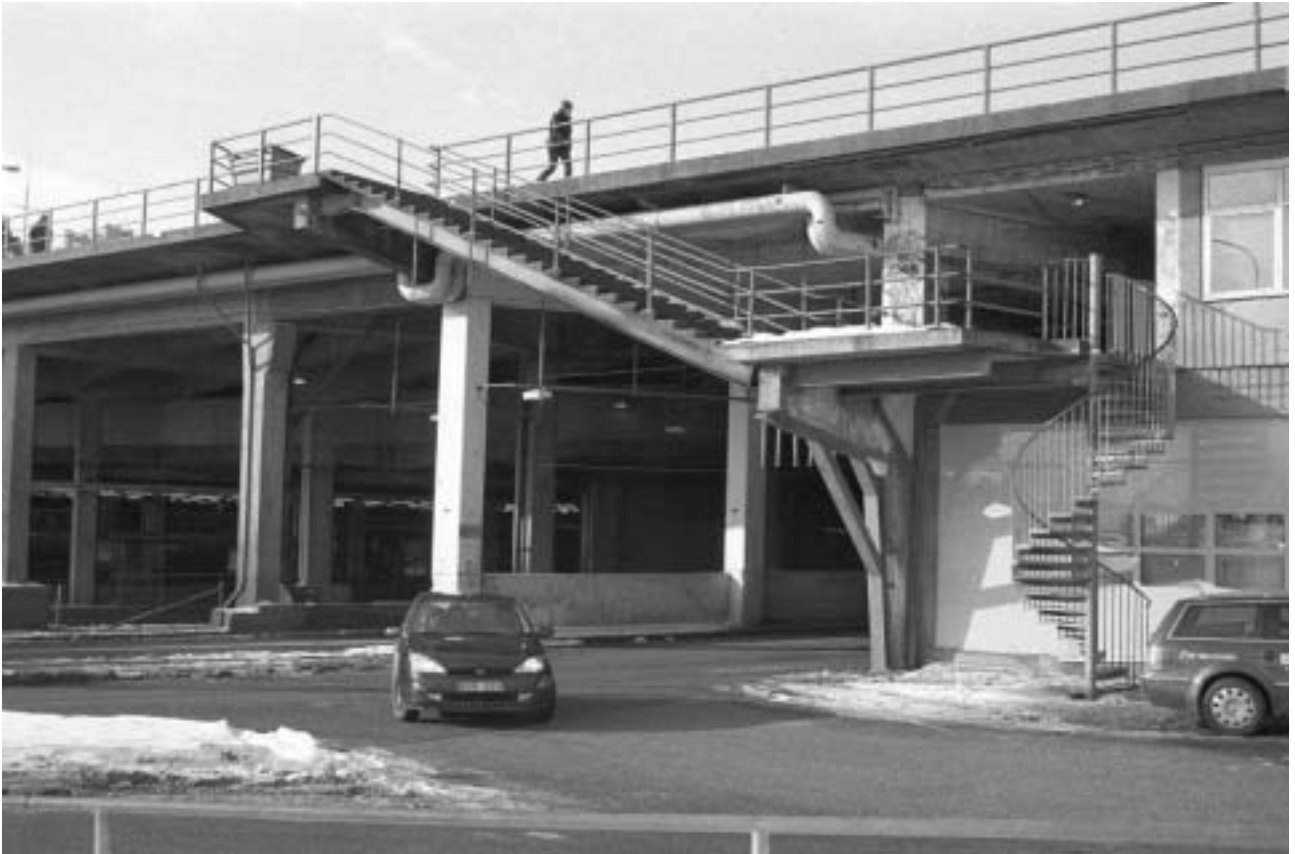
Trappan mellan Östra Slussgatan och trottoaren vid Saltsjörampen. Det nedre trapploppet är sekundärt. GF S2005-0014-16.
