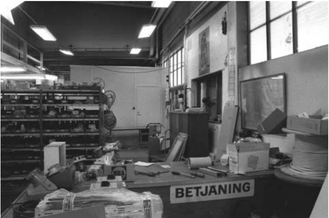
Lokaler under Katarinavägen och Skeppsbron. Det f.d. östra maskinrummet för slussportarna. GF S2005-0031-04
