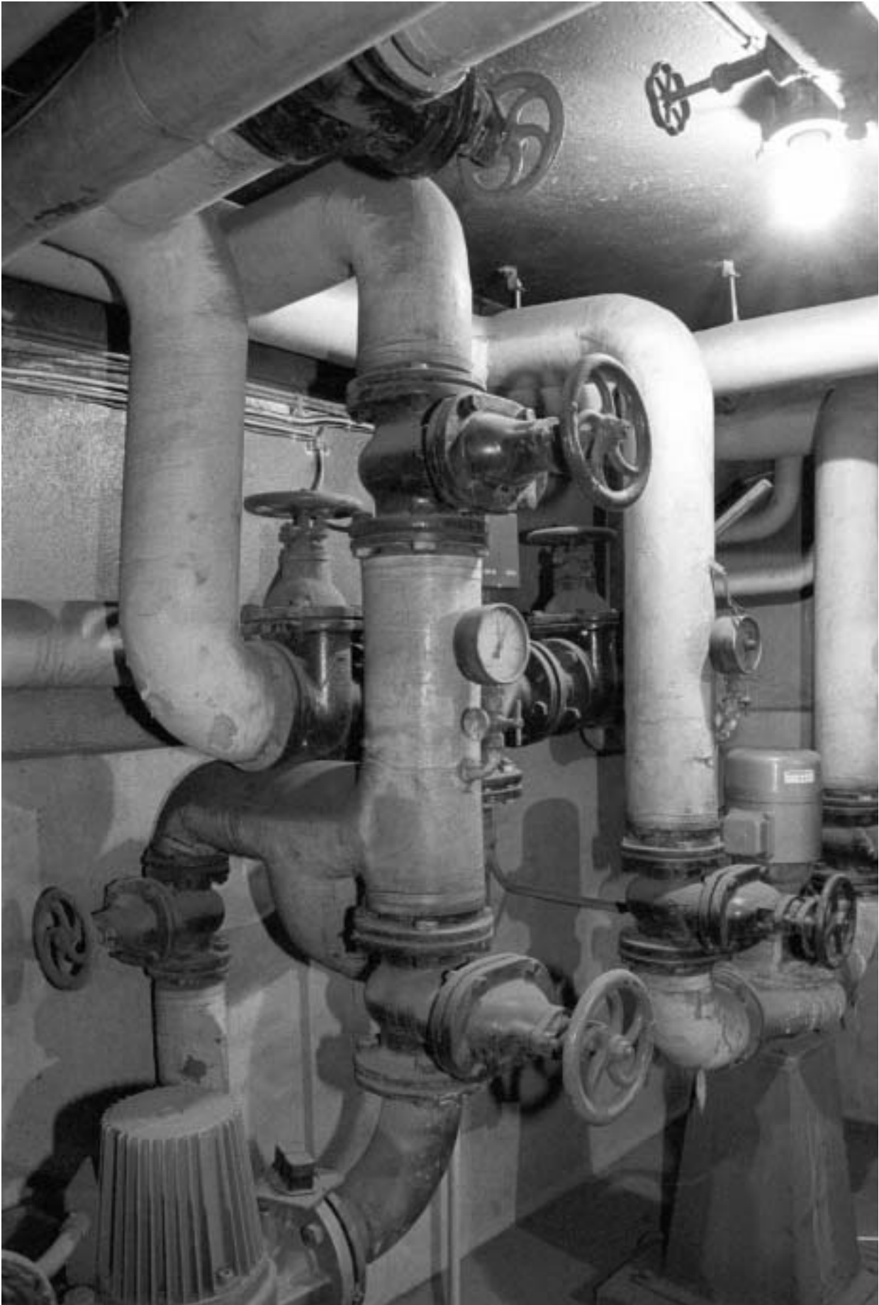
Pannrummet i källarvåningen. GF S2005-0029-29.
