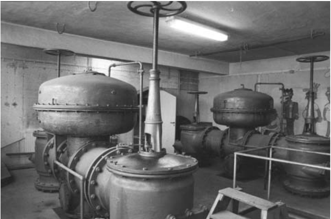
Lokal E, interiör. Gaspumpstationen i bottenplanet. GF S2005-0037-26A.
