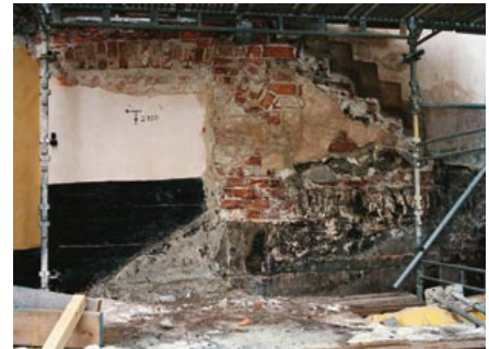
Bottenvåningens mur sedd utifrån gården. En sekundär igenmurad dörröppning med ovanliggande valv finns i det putsade svarta och vita partiet till vänster i bild. Till höger om denna finns tre halvstenar från den ursprungliga dörrrens valv. Foto: Göran Fredriksson, SSM.
