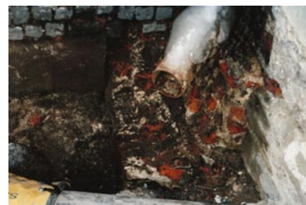
Murverket i bottenvåningens nedre delar, mellan tornet till vänster och Överkommissariens hus till höger. Det finns ingen stötfog mellan de två byggnadernas murar, tegelmurens utsida är bortriven och kärnan blottad. Under stuprännan finns delar av en sockel i natursten bevarad. Foto: Anna Bergman, SSM.
