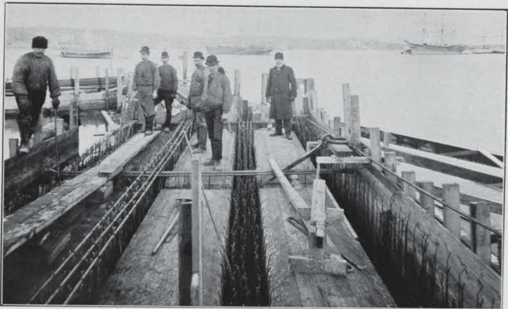
FORMAR JÄMTE ARMERING TILL JÄRNBETONBALKAR MELLAN KISTPELARE FÖR VÄSTRA KAJEN I TEGELVIKSBASSÄNGEN.
